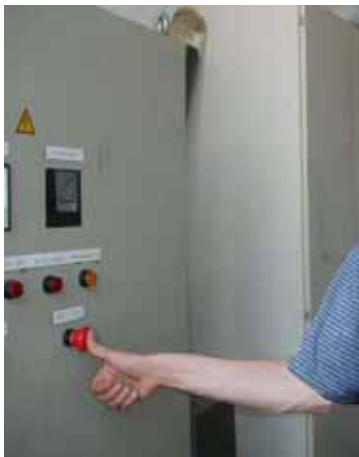
Bild 1: Bedienelemente an einer elektrischen Schalteinrichtung
